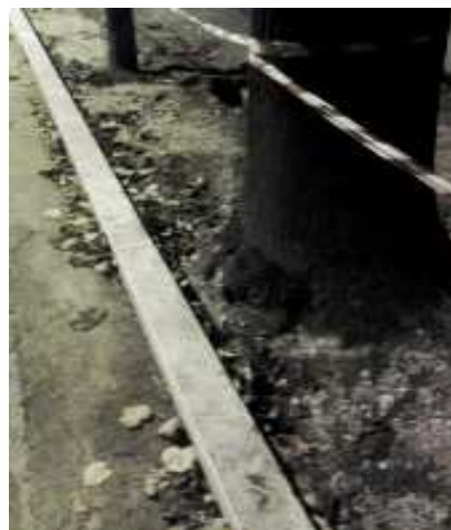
L'intervento di "sistemazione dell'apparato radicale" sul tratto di Viale Nettuno da Piazza della Stazione verso Nord
